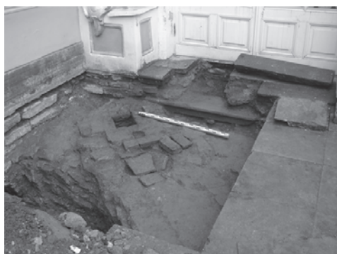
Водоприемный колодец и погребенная ступень у дверного проема галереи со стороны парка у Zubовского флигеля. 2009
