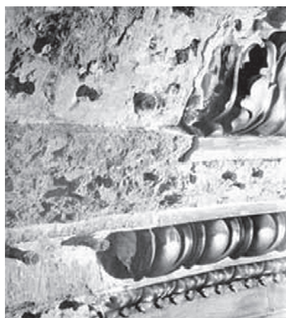
Состояние лепных орнаментов
