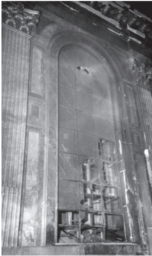
Витраж Исаакиевского собора. До реставрации
